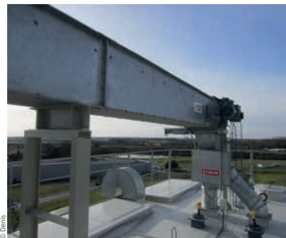
→ Transporteur à chaînes en partie haute.
